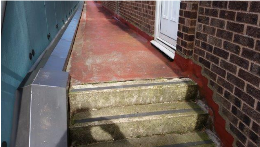
▲ F.24 Mortar fillet cracked
